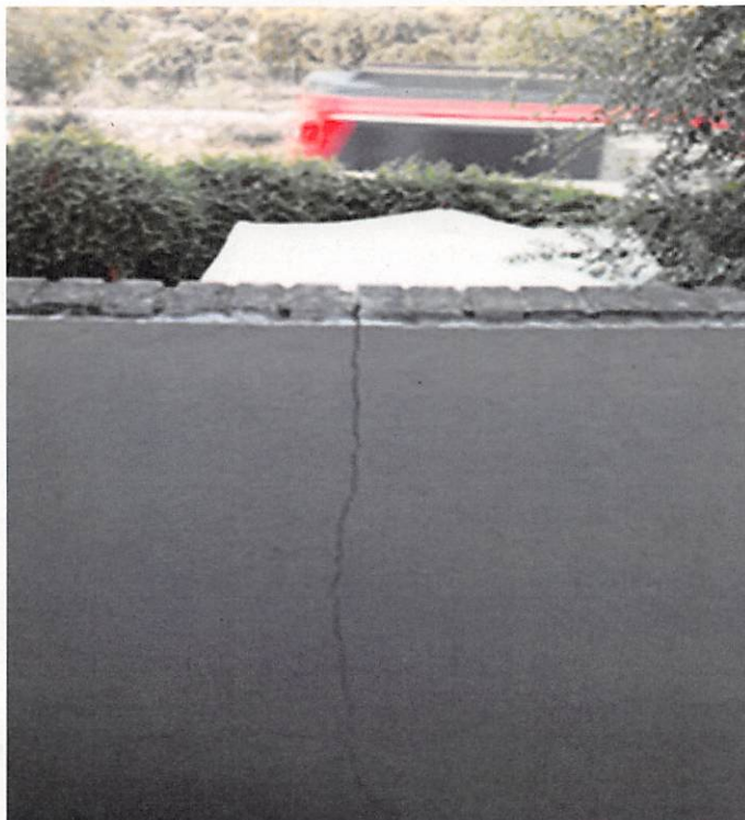
Foto grieta en la casa de un vecino de El Torreón
